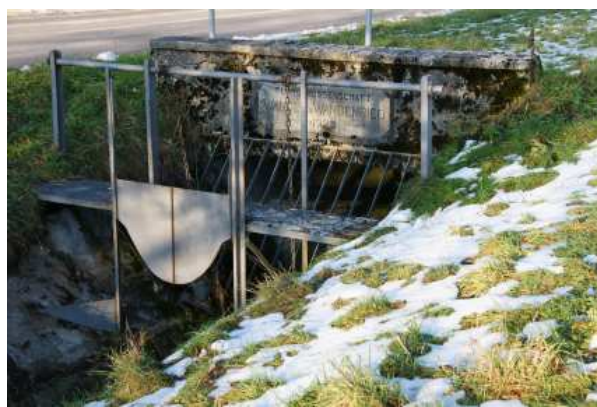
Entwässerungskanal und Eiformleitung bei der asm (früher OAK). ‚Flurgenossenschaft Wangen-Wangenried 1923‘.
